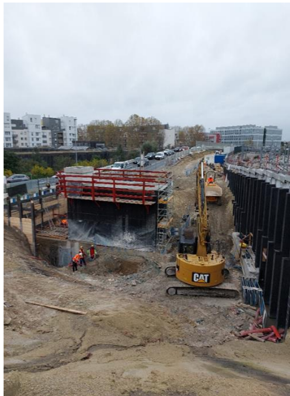
Trémie matériel réhaussée, paroi berlinoise en cours de réalisation, étanchéification des voiles de la galerie en cours
