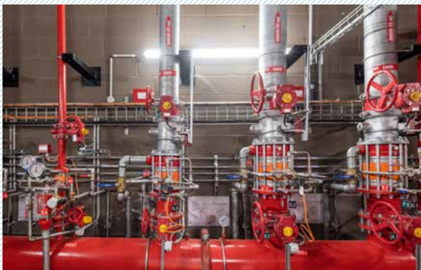
Un renforcement des moyens de lutte contre l'incendie
