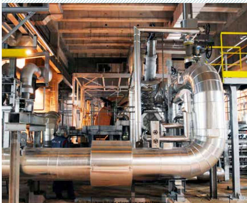
Optimisation de la production de chauffage urbain
