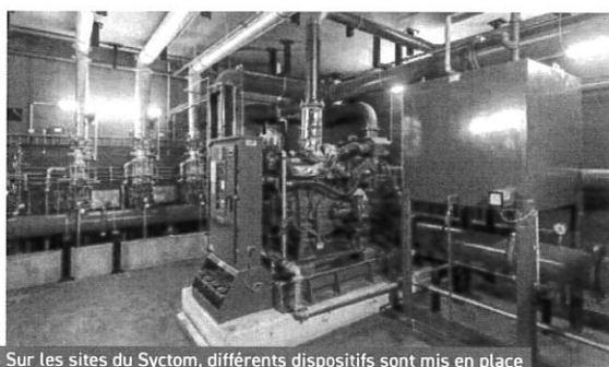
Sur les sites du Syctom, différents dispositifs sont mis en place pour détecter, contenir et éteindre tout départ de feu.
