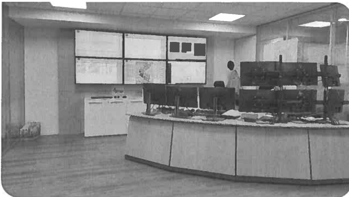
Figure 9 : Poste de contrôle GAIA dans les locaux de Suresnes
